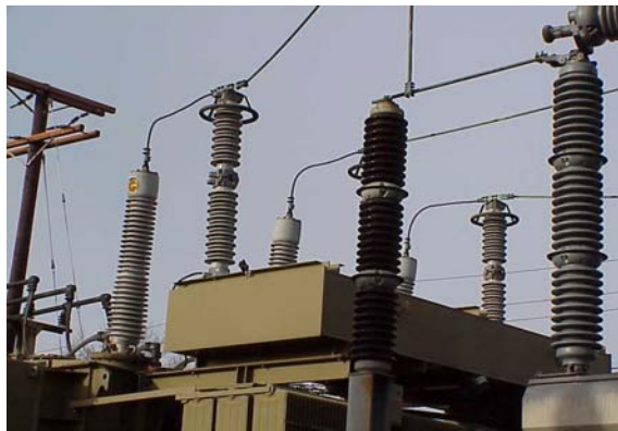
Fig. 22. 230 kV Lightning Arrester
