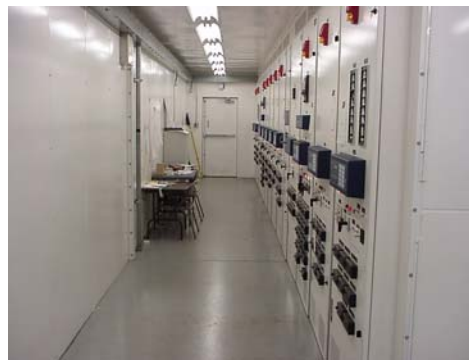
Fig 24. 4 kV Switchgear (Inside)
