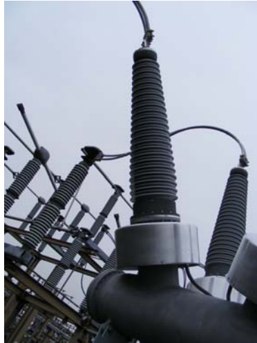
Fig. 19. 230 kV 2000/5 A Bushing CT
